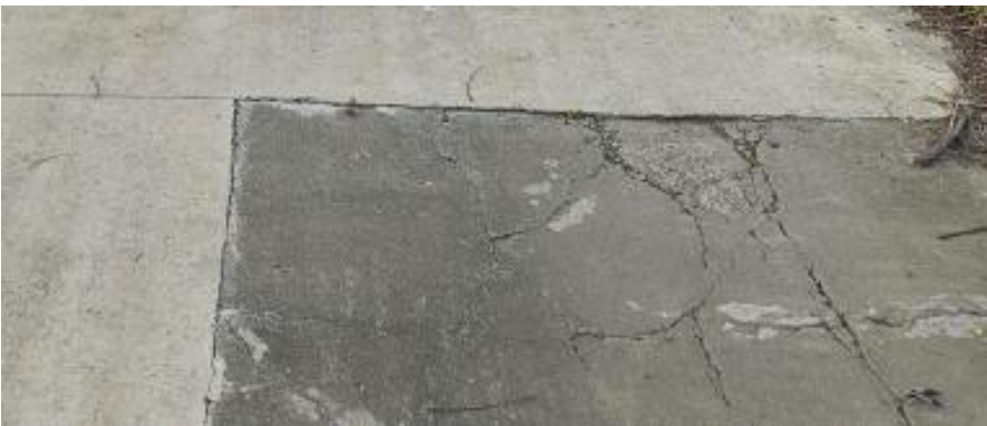
混凝土路面破碎
