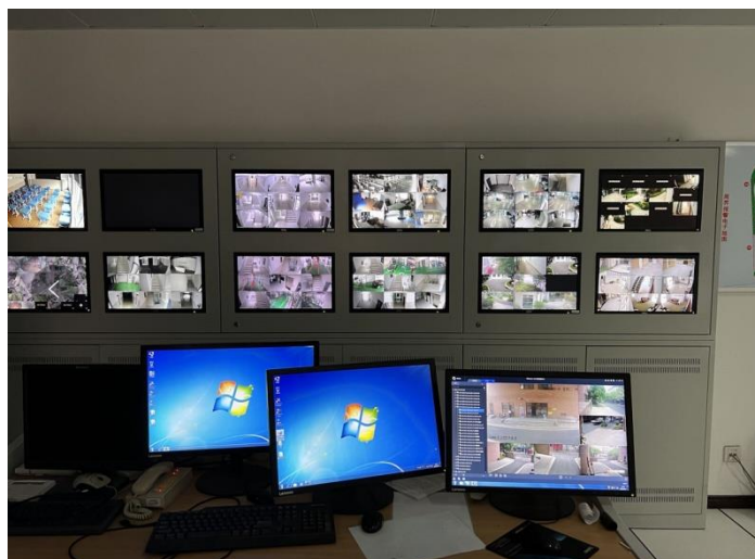
图 2-5 新建 17/18 号楼监控室，接入部分校门口视频
