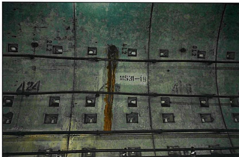
图16 上行线 425 环内侧连接块与拼装块有渗漏痕迹
