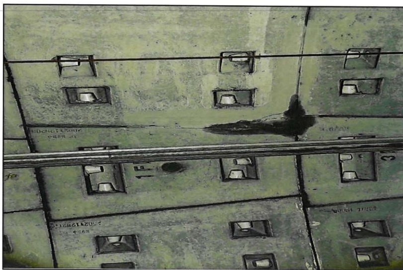
图20 下行线 254 环上方封顶块与内侧连接块有湿迹
