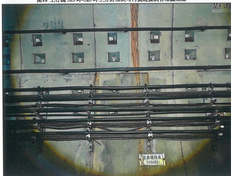
图19 下行线 233 环内侧连接块与拼装块有堵漏痕迹
